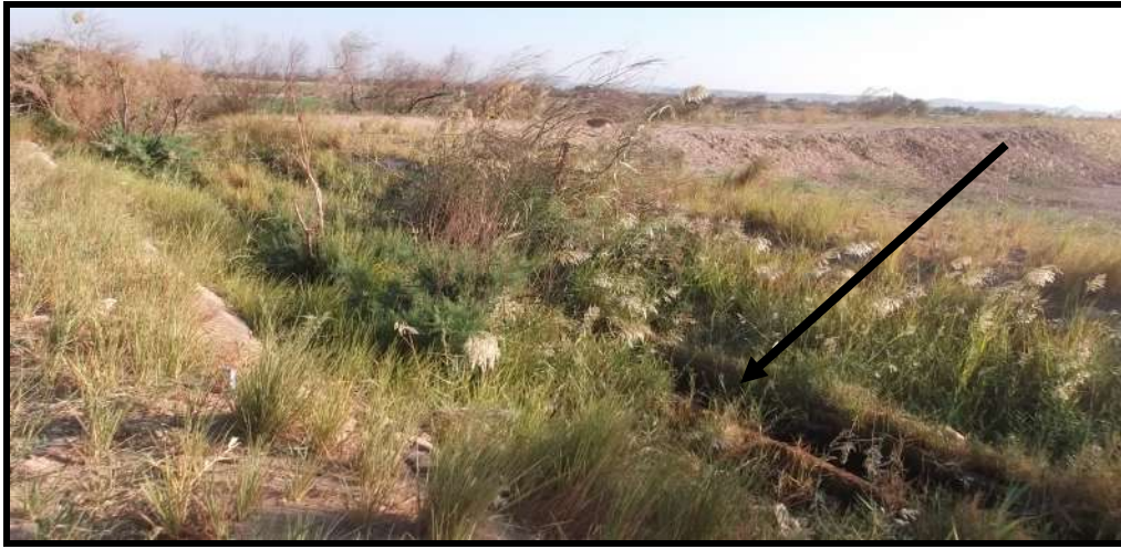
صورة (١٦) سوء تطهير وتكسير قنوات الري (التبطين) التابعة لبئر ١٥ بسهل الزيات بمركز بلاط عام ٢٠١٥ م المصدر: الدراسة الميدانية يوم الجمعة الموافق ٢٠١٥/١٢/٤م، وتقع إحداثيات الصورة عند منسوب ١٦٩,٨ متر ودائرة عرض ٢١ ١٢ ٢٥ شمالاً وخط طول ٢٠ ٤٧ ٢٩ شرقاً واتجاه الصورة ناحية الشمال الشرقي
